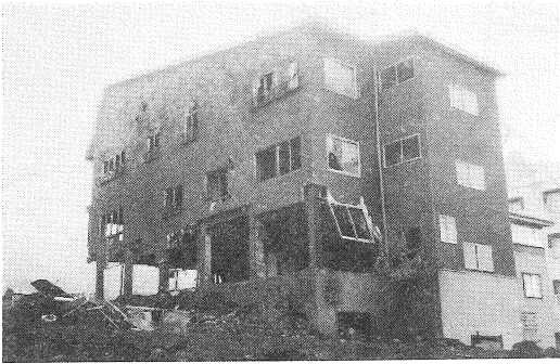
写真3. 西原山荘の被害
