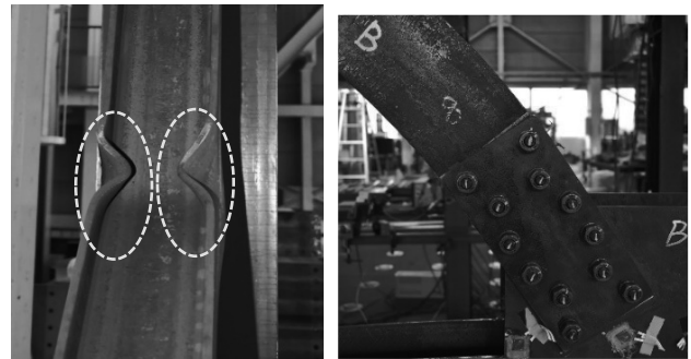
(b) ブレース材の局部座屈
