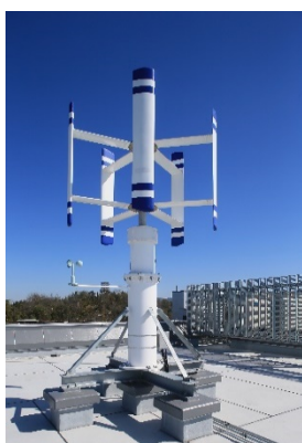
風力発電装置 (2 kW)
