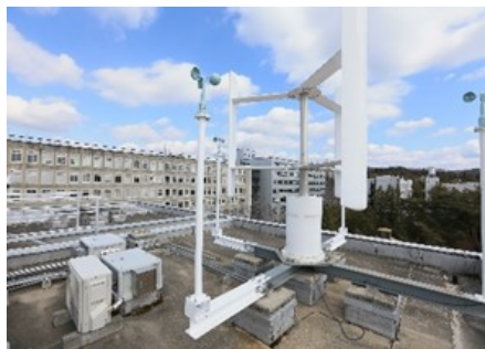
風力発電機(実験機)
