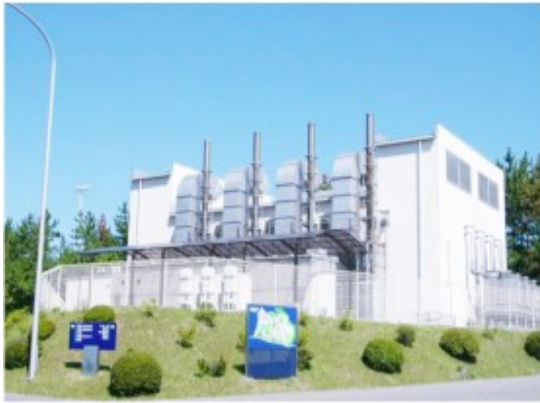
自家用発電機実験装置
