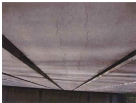
写真 3.1 ASR により PC 桁橋下面に生じたひび割れ事例 3.4)
