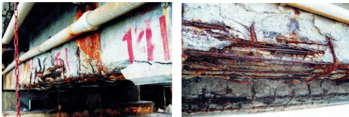
写真 1.1 野甫大橋におけるコンクリートの劣化 4.2)
