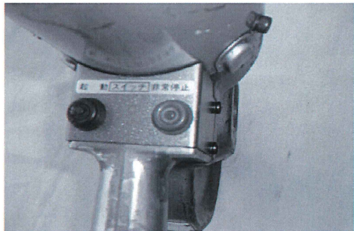
写真12【非常停止スイッチ】
