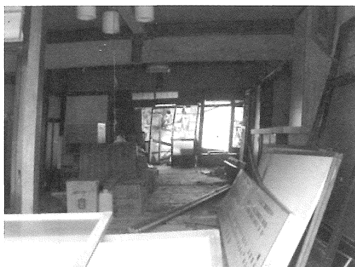
写真3 室内の被害（その後取り壊された）
