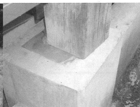
写真6 法相寺の本堂の柱が7cm ずれている。
