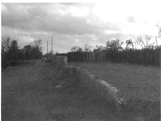
写真11 越流無しで破堤した止水壁
