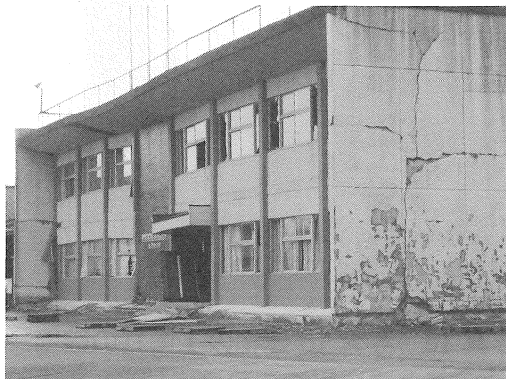
被害にあった建物
