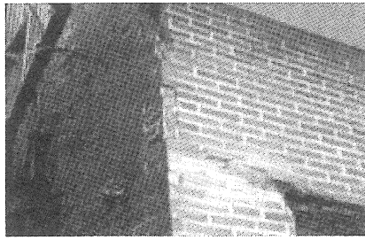
写真1 商店街建物の被害の様子
