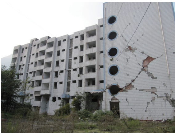
写真 14 漢旺鎮被害建物 D
