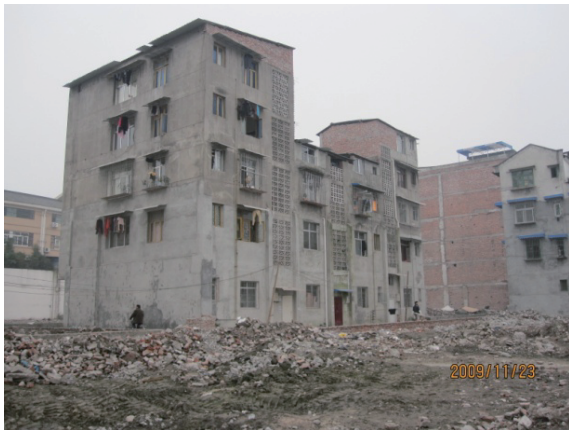
写真 1 都江堰市内の被害の様子 (2009.11.23 撮影)
