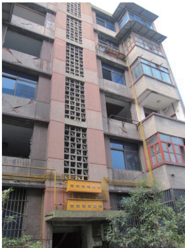
写真 12 漢旺鎮被害建物 B
